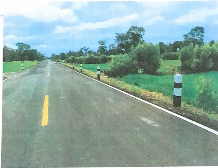
รูปภาพประกอบโครงการก่อสร้างถนนลาดยางผิวจราจรแอสฟัลท์ติกคอนกรีต สายบ้านลำโรง หมู่ที่ ๕ บ้านหนองใหญ่ หมู่ที่ ๒ ตำบลหนองใหญ่ อำเภอปราสาท จังหวัดสุรินทร์
